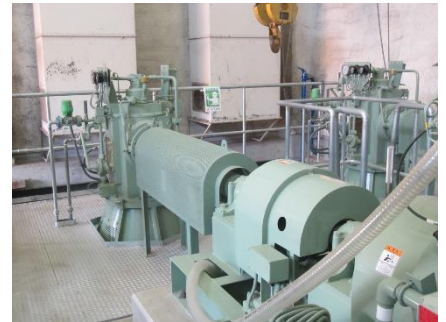
更新・改修された新しいポンプ 平成 30 年 2 月 26 日
